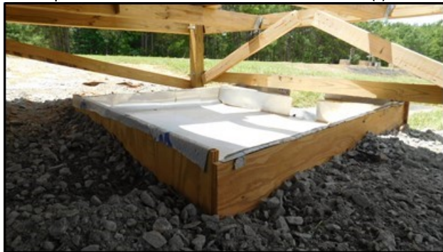
(g) effluent collection platform
