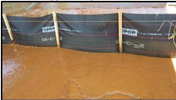
(c) C-POP effluent discharge
