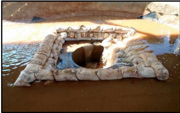
(d) Square Barrier Failure
