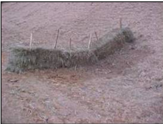
a. Ditch Check
