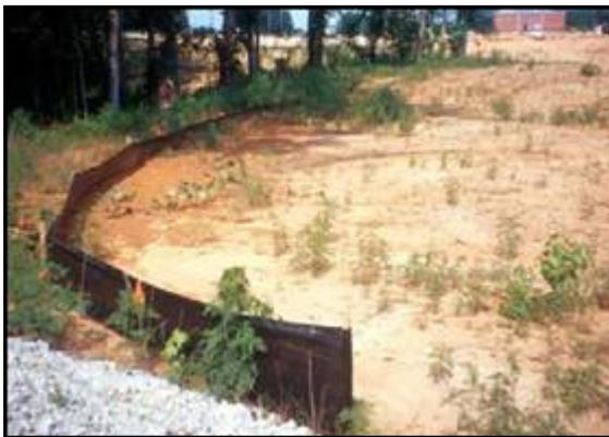
a. Sediment Barrier
