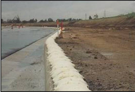
a. Sediment Barrier
