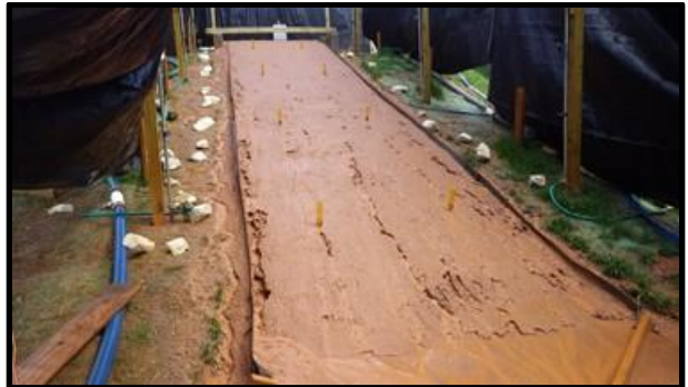
(d) slope erosion after interval 3
