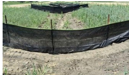
(d) SF-M1 field installation
